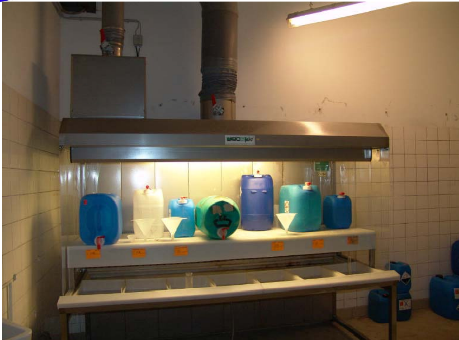
Säureabfüllstation der Universität Oldenburg Beispiel für geeignete Arbeitsmittel bzw. Absaugung an der Gefahrenquelle
